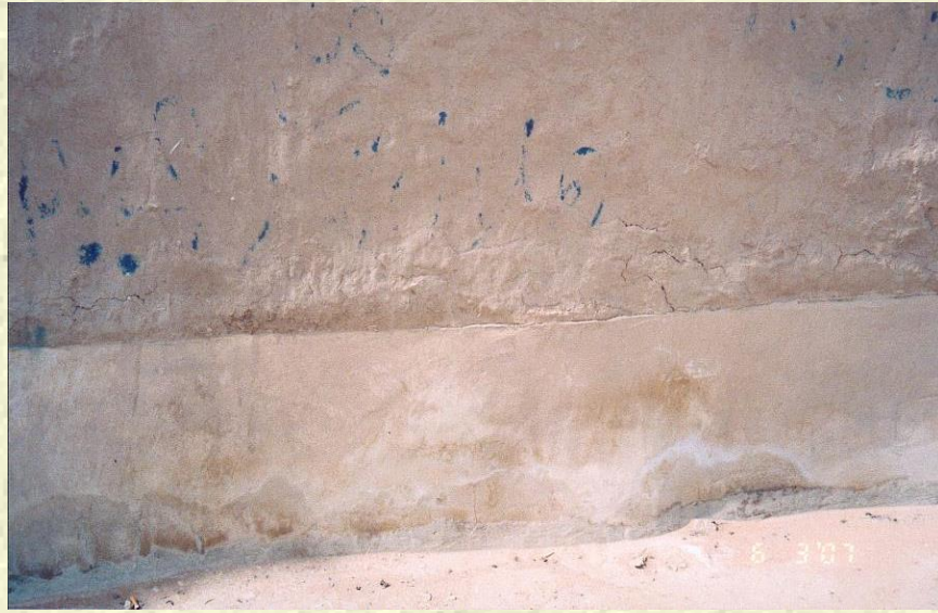
حمام الطريف : الواجهة الشمالية – تزهـر الأملاح علي السفل الأسمنتي
