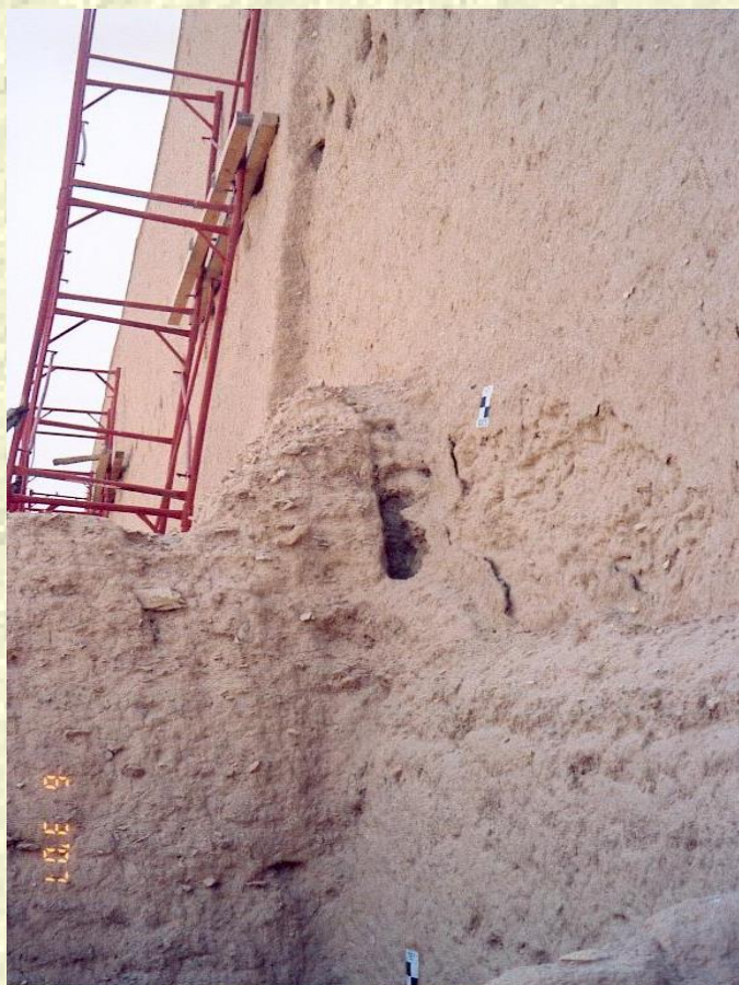
قصر سعد : الواجهة الشمالية الغربية إنبعاج في الحوائط – تدعيم غير كافى
