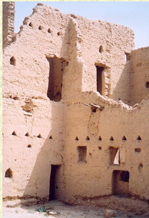
قصر عمر : فناء داخلي تدهور الإنشاء
